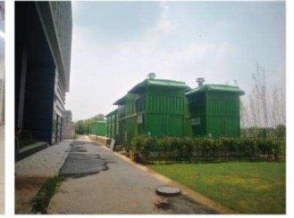
▲ 银行用发电机组 Bank generator set
