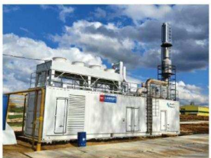
俄罗斯某电站项目 A power plant project in Russia
