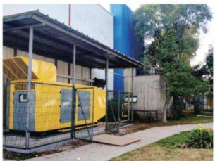
台湾某沼气发电项目 A biogas power generation project in taiwan
