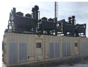
哈萨克斯坦某天然气电站项目 A natural gas power plant project in kazakhstan
